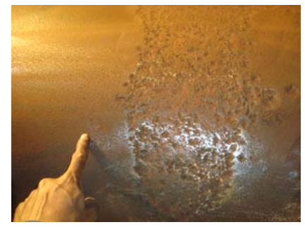
ผิว Pulley ขรุขระเพราะโดนสนิมกัดกร่อน ต้องทำให้ผิวเรียบก่อนจึงหุ้มได้
